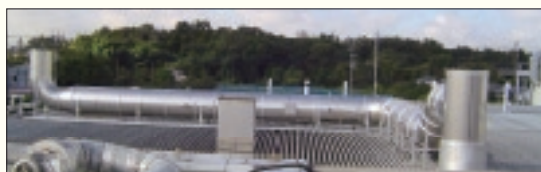
スプレー式脱臭ダクト
